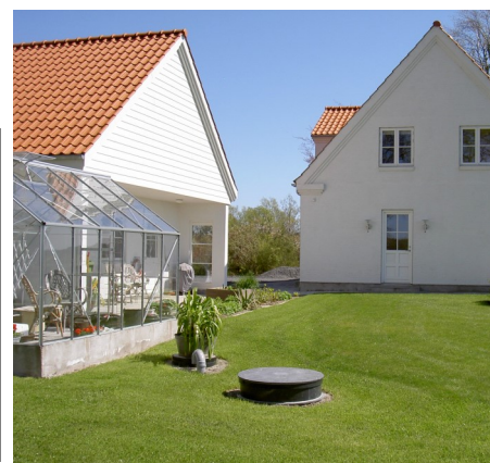
Pluto installerat vid ett enfamiljshus
